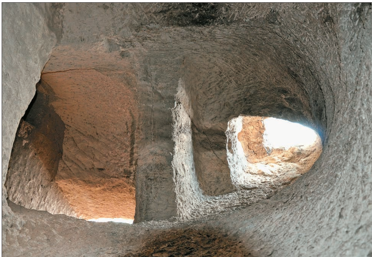
Трещина в колонне, вертикальной стене и на потолке.
